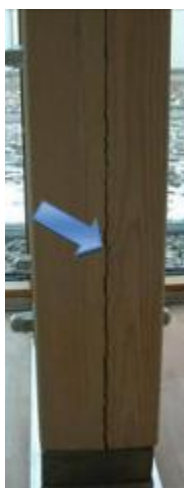
Obrázek 6 Svislá trhlina ve sloupu (ŠMAK, STRAKA, 2013)
