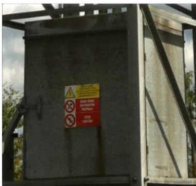
Obr. 13 Skříň rozvaděče NN
