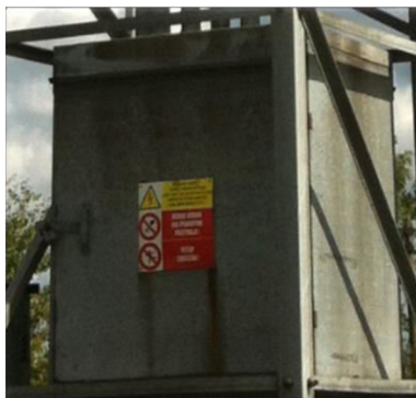
Obr. 13 Skříň rozvaděče NN
