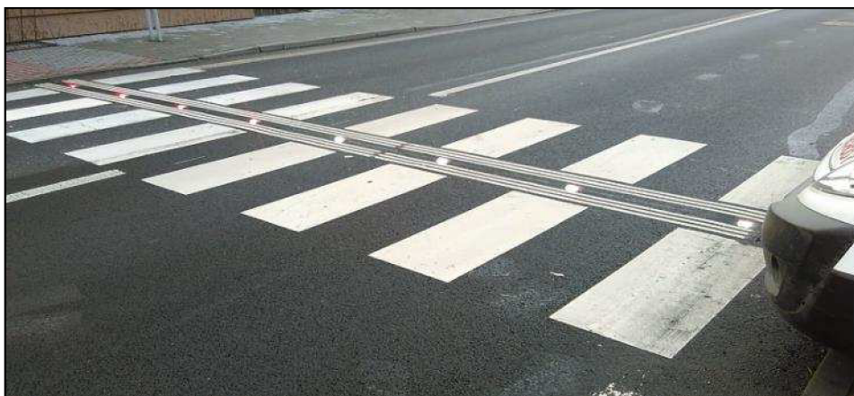
Obr. 17: Přechod osvětlený svítidly zapuštěnými do vozovky. Zdroj (36)
