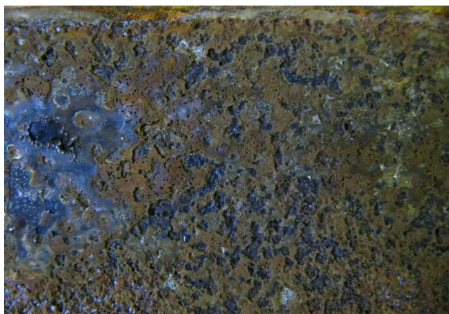
Obrázek 14: Detail vlivu koroze [14]
