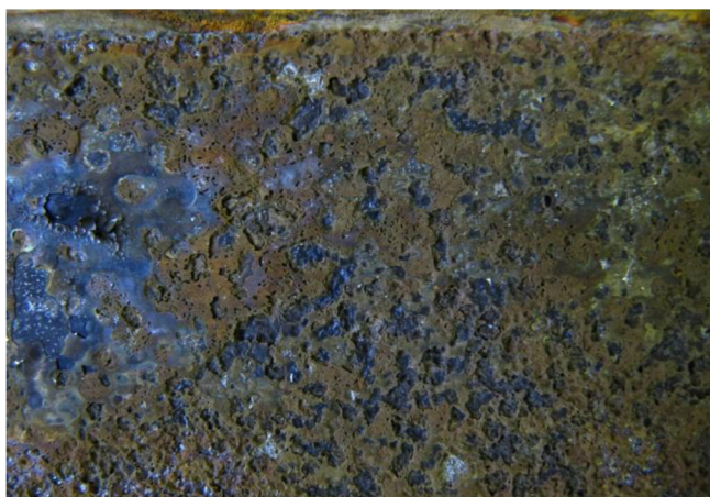
Obrázek 14: Detail vlivu koroze [14]
