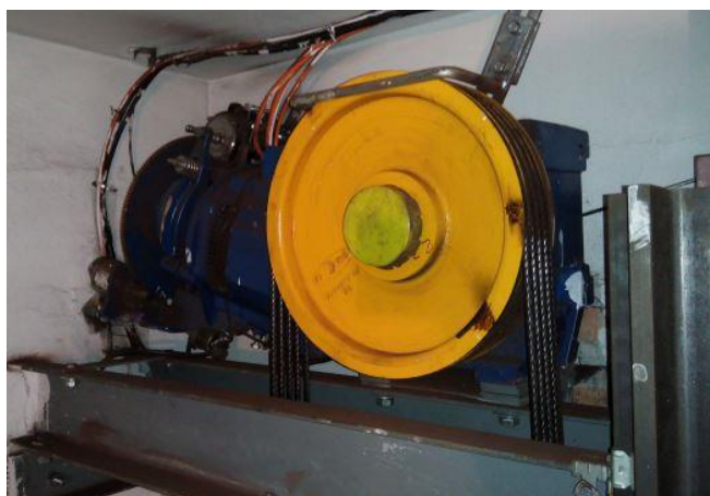
Obr. 9 Foto umístěného pohonu na výtahu 613-1-217 ve stanici pražského metra Ládví
