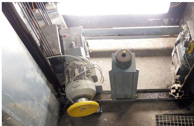
Obr. 10 Foto místěného pohonu na výtahu 613-1-423 ve stanici pražského metra Prosek
