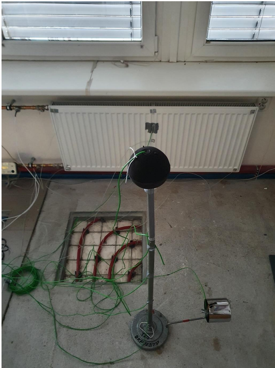
Obrázek 112 – Otopné těleso měřeno čidly – umístění čidel, kulový teploměr
