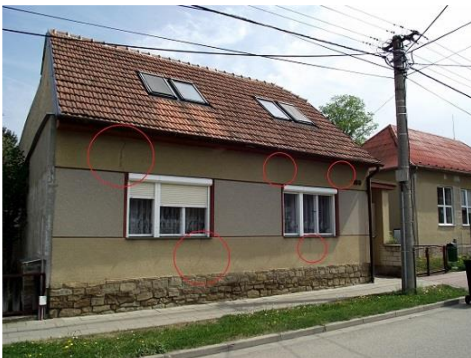
Obr. 8. Poškodená budova na ulici Tyršova p.č. 163 s vyznačenými prasklinami (červenou farbou)
