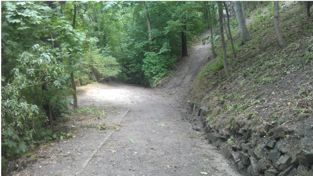
Obr.č. 17, Rozcestí na hlavní severní cestě nebudí příliš dobrý dojem. Povrch cest i opěrné zídky jsou ve velmi špatném stavu. Zdroj: vlastní
