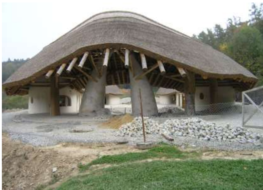
Vstupní objekt ZOO Jihlava ve fázi rozestavěnosti. Objekt bude obsahovat provozy pokladen, obchodu a občerstvení, hygienic.zázemí, víceúčelového sálu apod.
