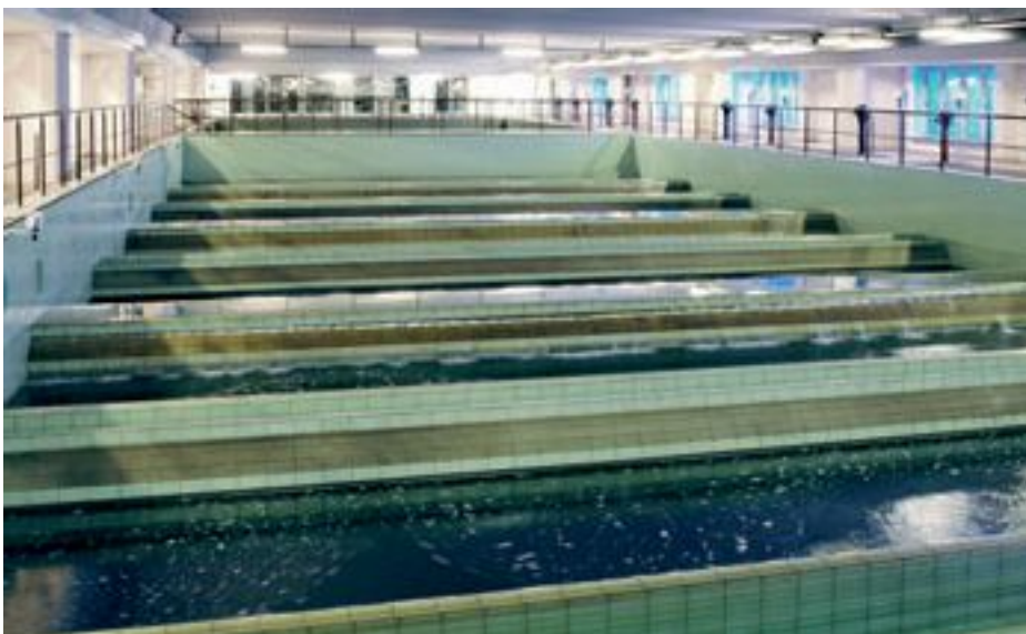
Úpravná vody Švařec – filtry
