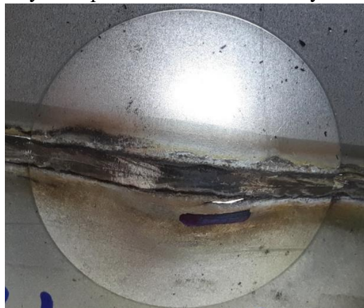
Obr. 55 Trhlina v TOO svaru.
