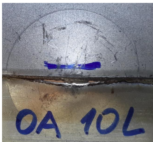
Obr. 54 Nepřípustná trhlina ve svaru.
