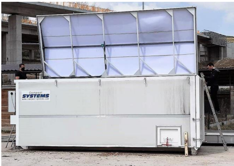
Obr. 3.14 Hygienizačné zariadenie – CSC kontajner na kompostovanie bioodpadu
