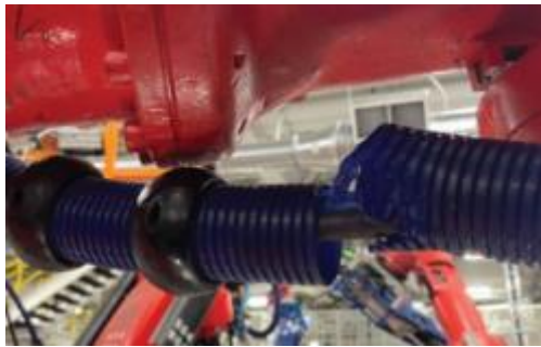
Obr. 23 Pretrhnutie ochrannej hadice v dôsledku nedostatočnej dĺžky [29]
