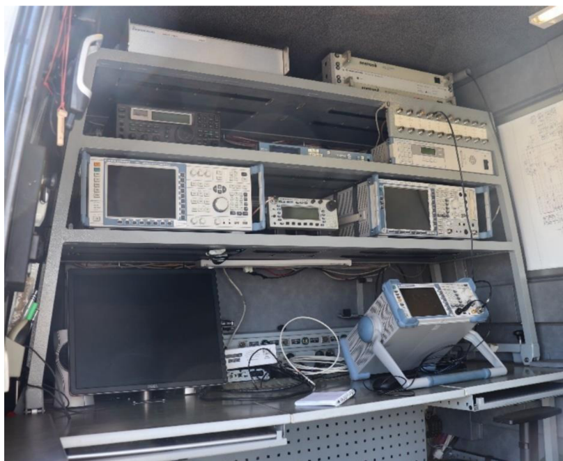
Obr. 29 Technické vybavení měřicího vozu
