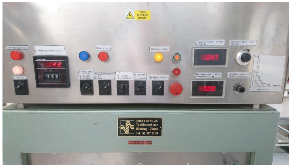
Obrázek 19: Kontrolní panel termofixačního stroje během fixace košiloviny
