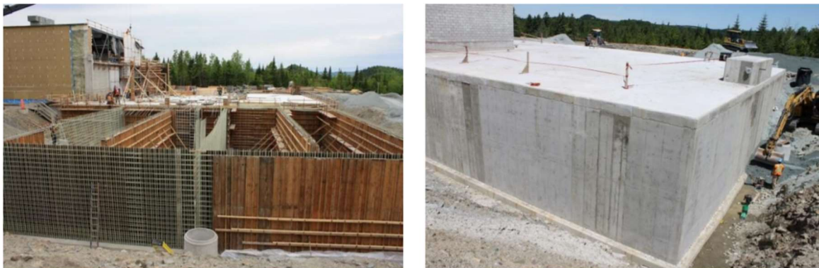
Obrázek 19 Vlevo-FRP vyztužování zdí, vpravo-vnější pohled na nádrž [12]
