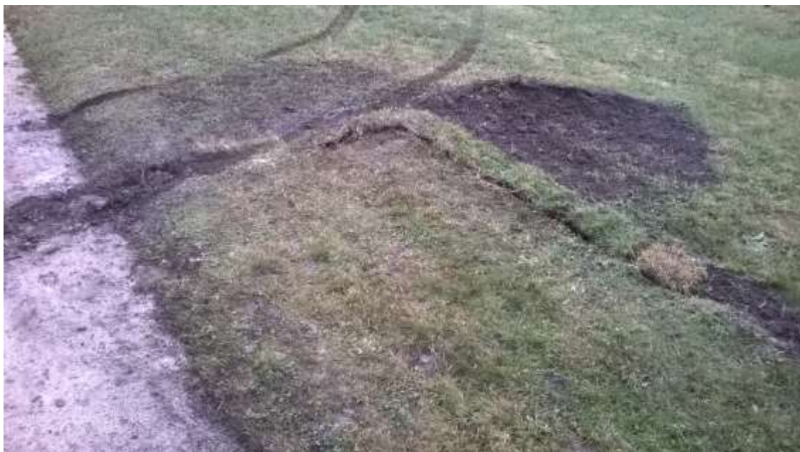
Obr.6: Príklad nedostatočnej dokončovacej starostlivosti i poškodzovania plôch pojazdom mechanizácie, ktorá následne spôsobuje problémy pri údržbe (foto autor).
