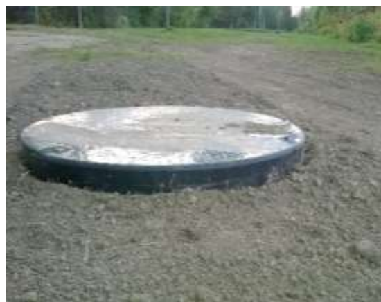
Obr.8: Nedostatočná dokončovacia starostlivosť – poklop závlahovej šachty nie je zarovnaný s povrchom trávniku (foto autor).
