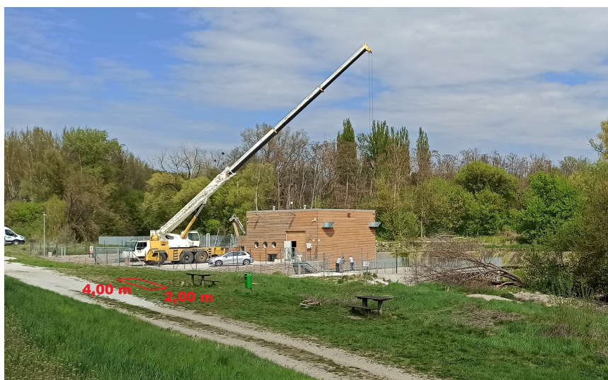
Obr. 4.32: Vhodné miesto pri vodnej elektrárni. [zdroj: vlastný].
