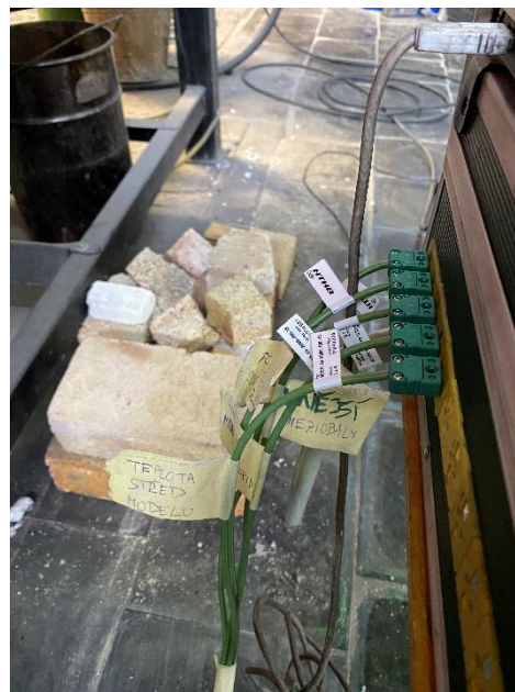
Obr. 56 Zapojené vodiče termočlánků do sběrnice AD převodníku.
