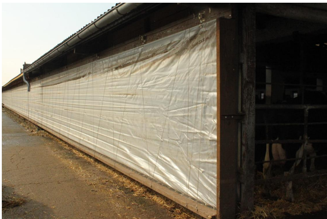
IV: Vybavení podélných stěn stáje stahovacími roletami – regulace mikroklimatu (zdroj: vlastní)
