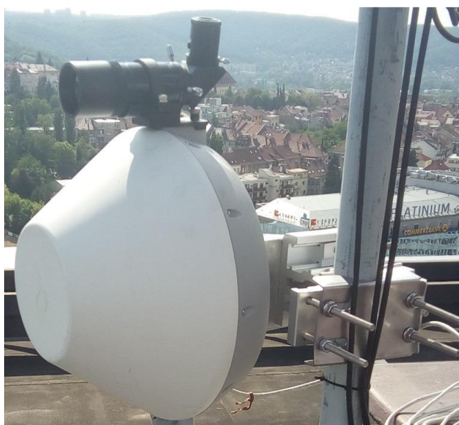
Obr. 4.10: Jednotka PTP spoje Metrolinq Ignite umístěna na budově A Šumavská se zaměřovacím dalekohledem
