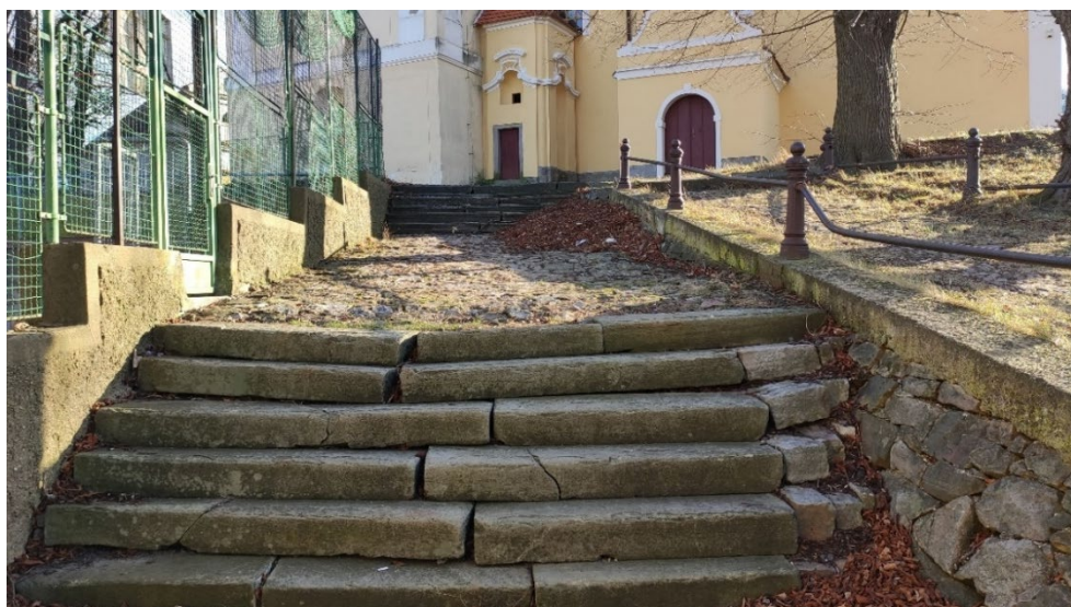
Obrázek 19 Schodiště v dezolátním stavu (autor: Jan Michalica)
