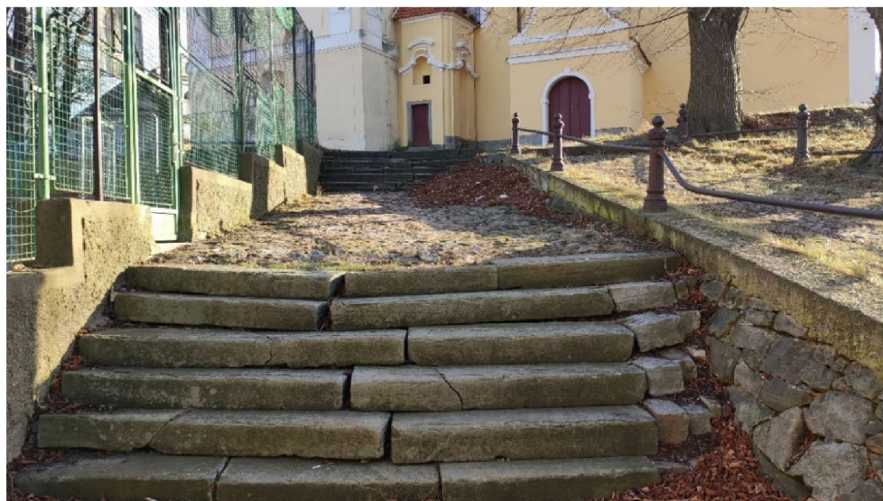
Obrázek 19 Schodiště v dezolátním stavu (autor: Jan Michalica)
