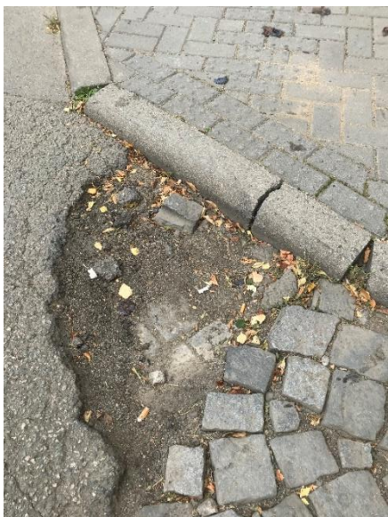
Obrázek 106 Špatný technický stav komunikace
