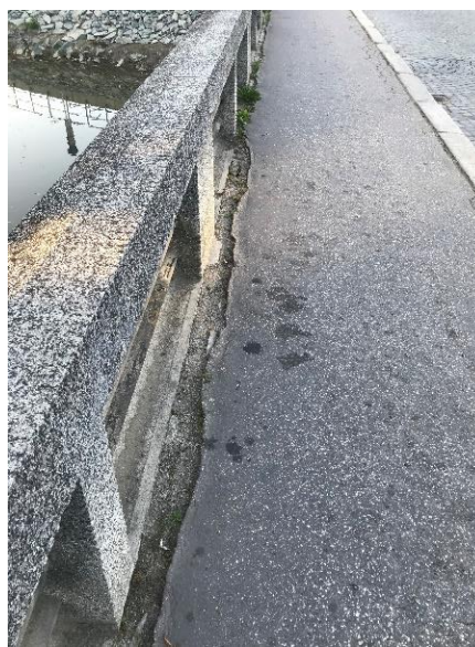
Obrázek 50 Špatný technický stav chodníku
