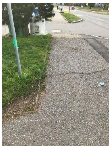
Obrázek 264 Špatný stav a výška vodící linie
