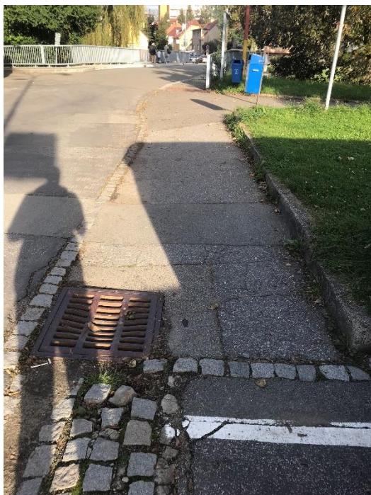
Obrázek 213 Špatný technický stav chodníku
