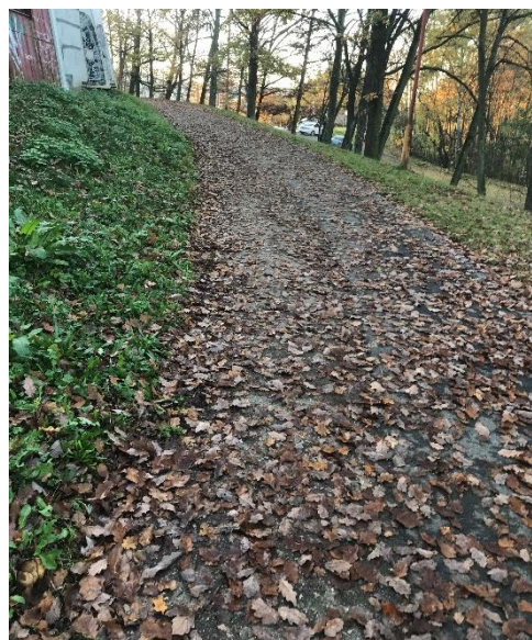
Obrázek 251 Chybějící vodící linie, neudržovaný chodník
