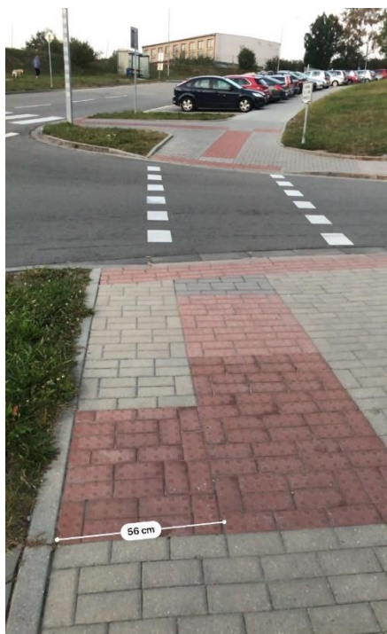
Obrázek 74 Napojení signálního pásu na nevyhovující vod. linii
