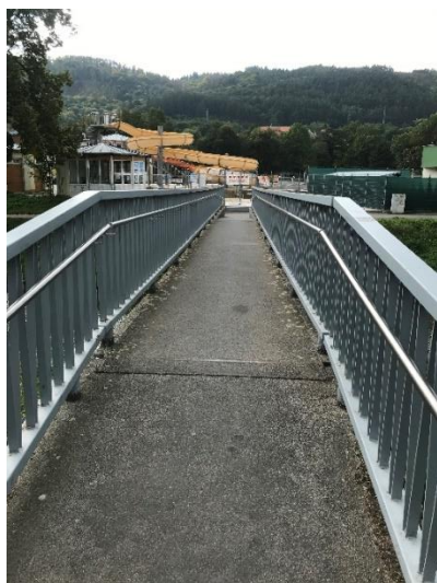
Obrázek 185 Nevyhovující průchozí šířka a sklon rampy
