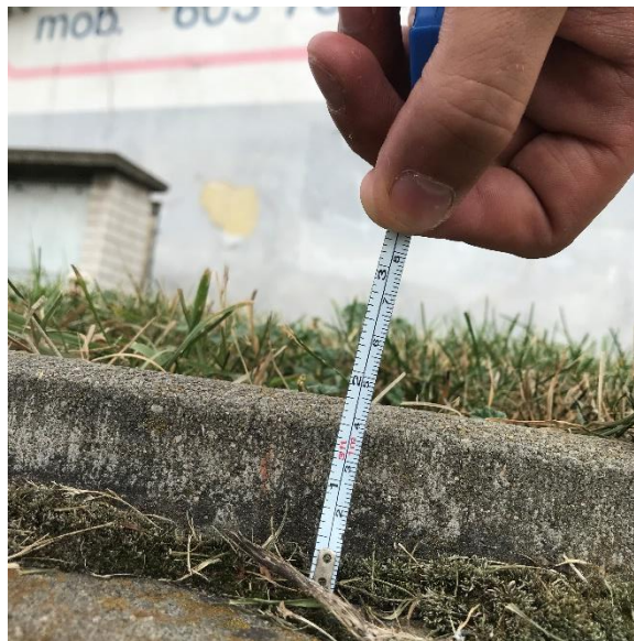
Obrázek 172 Nevyhovující výška vodící linie
