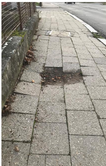
Obrázek 269 Špatný stav chodníku
