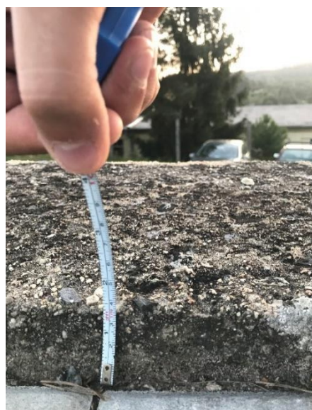
Obrázek 66 Nevyhovující výška vodící linie
