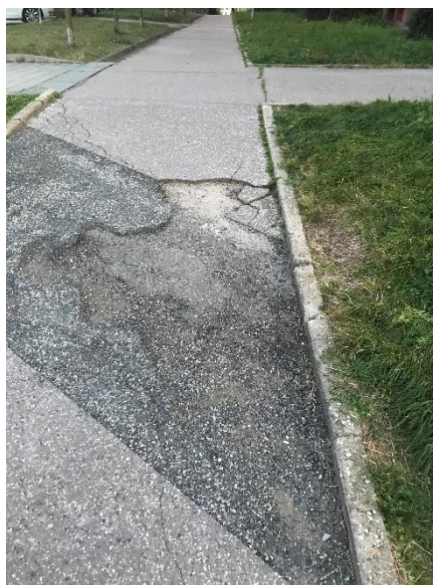
Obrázek 83 Špatný technický stav chodníku
