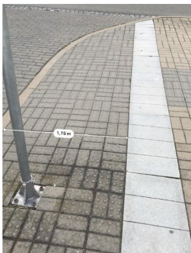
Obrázek 163 Nevhodné provedení hmatných prvků
