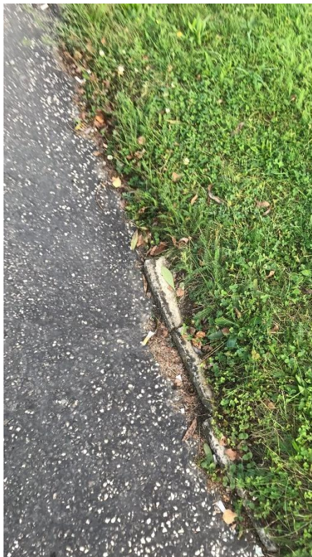
Obrázek 210 Špatný stav vodící linie
