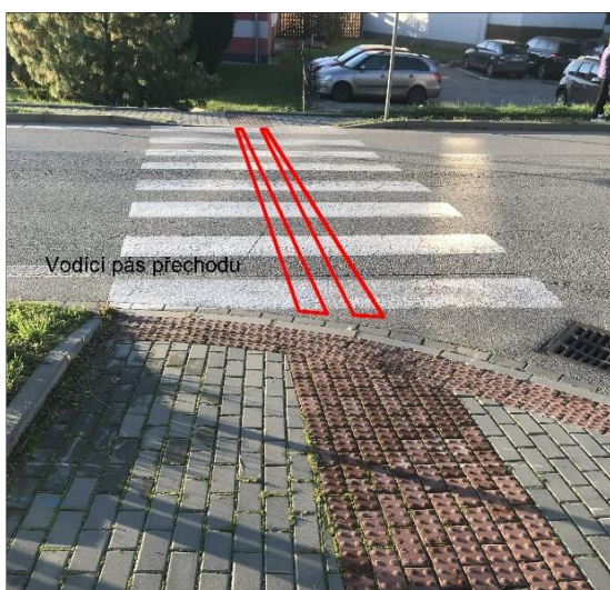
Obrázek 240 Chybějící vodící pás přechodu
