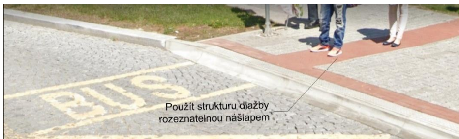
Obrázek 173 Signálního pás na zastávce MHD
