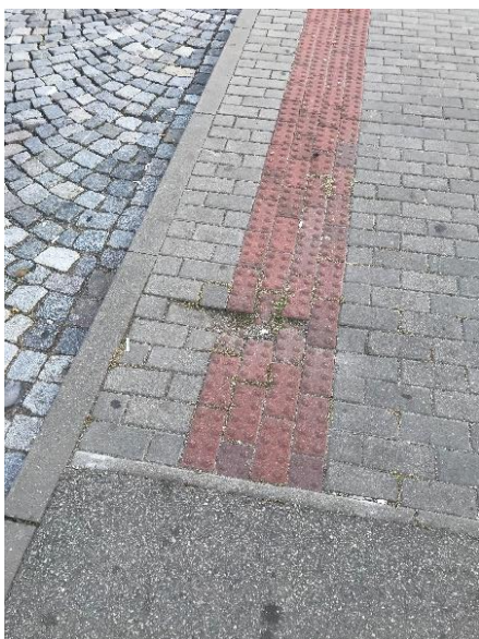
Obrázek 51 Špatný technický stav chodníku
