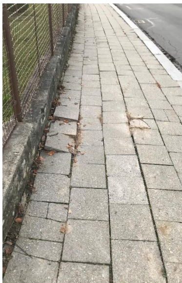
Obrázek 268 Špatný stav chodníku
