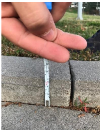
Obrázek 61 Nevyhovující výška vodící linie
