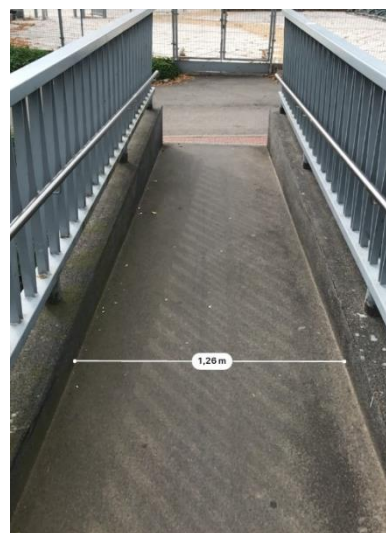
Obrázek 186 Nevyhovující průchozí šířka
