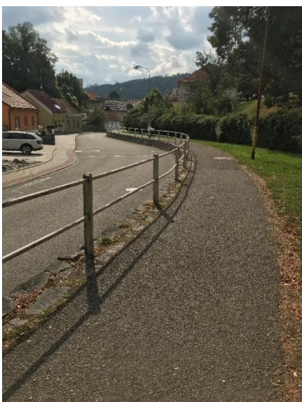
Obrázek 153 Chybějící vodící linie a bezpečnostní prvky
