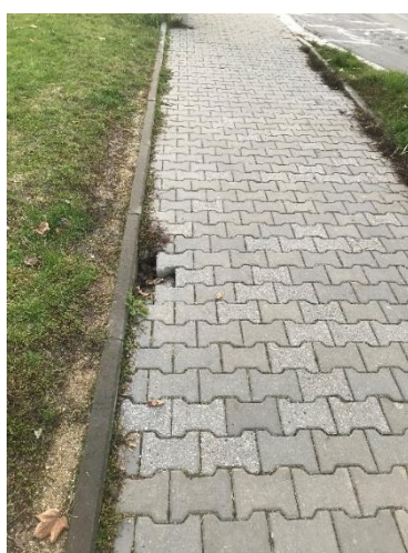
Obrázek 263 Špatný stav chodníku
