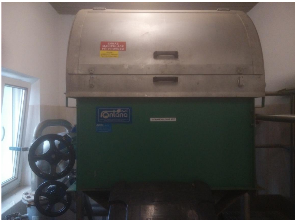
Obrázek 5-2 Stírané válcové síto na ČOV Moravičany
