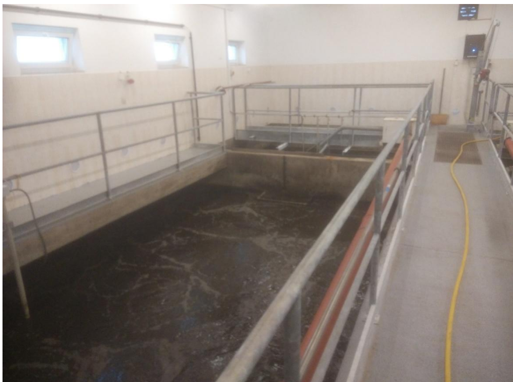
Obrázek 5-3 Provzdušňovaná aerační nádrž na ČOV Moravičany
