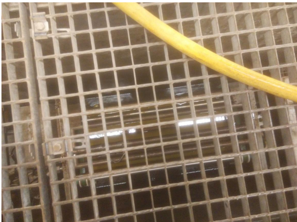
Obrázek 5-5 Mikrosítový filtr na ČOV Moravičany
