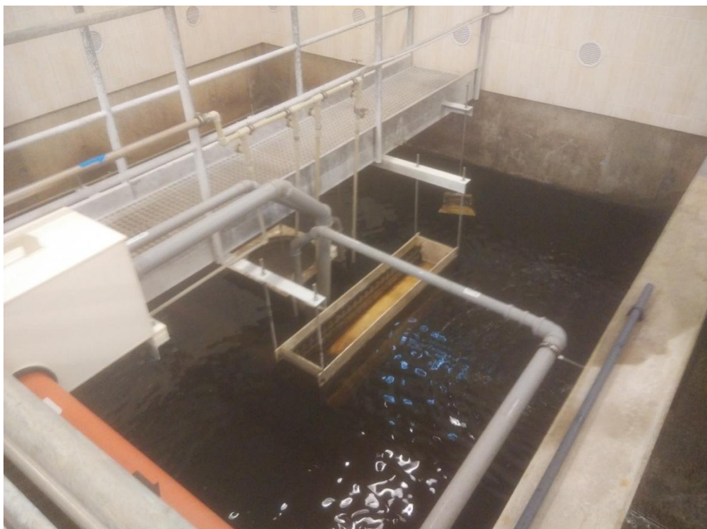
Obrázek 5-4 Dosazovací nádrž na ČOV Moravičany
