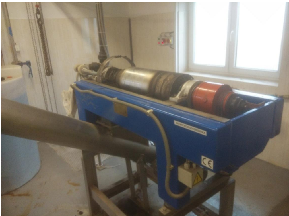
Obrázek 5-6 Dekantační odstředivka na ČOV Moravičany
