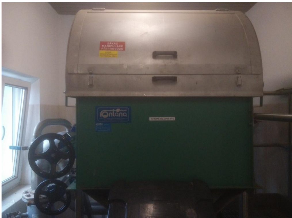
Obrázek 5-2 Stírané válcové síto na ČOV Moravičany
