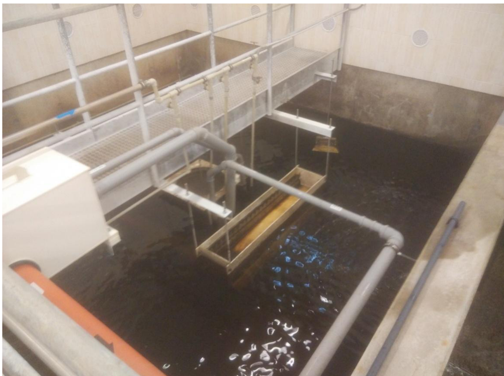
Obrázek 5-4 Dosazovací nádrž na ČOV Moravičany
