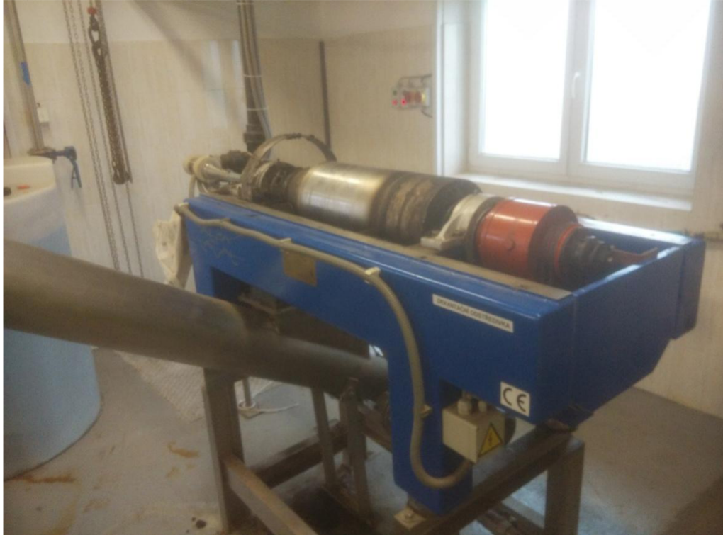
Obrázek 5-6 Dekantační odstředivka na ČOV Moravičany
