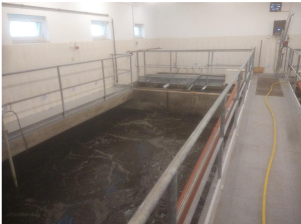
Obrázek 5-3 Provzdušňovaná aerační nádrž na ČOV Moravičany
