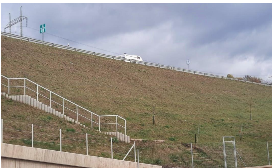
Obrázek 13: Násyp v km 41,300 současný stav (zdroj vlastní 2023)
