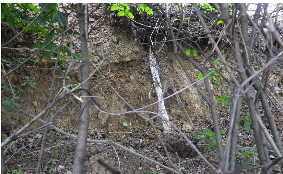
Obrázek 20: Obnažená drenážní trubka, sesuv svahu D1 km 304,0 (zdroj Kozák 2020)
