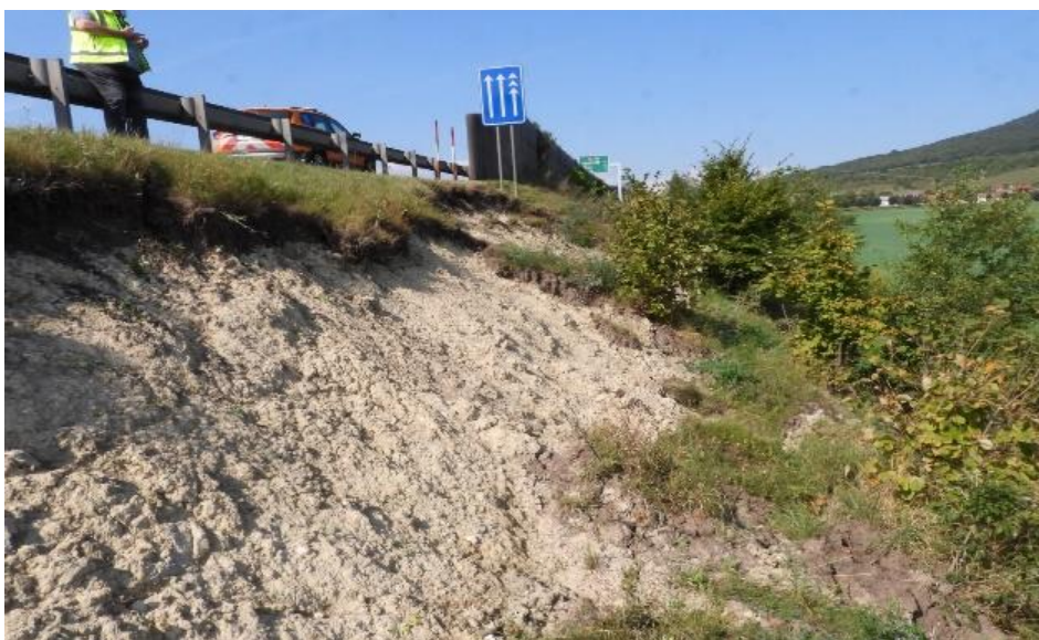
Obrázek 22: Sesuv humusové vrstvy svahu D8 km 49,3 (zdroj Kozák 2021)
