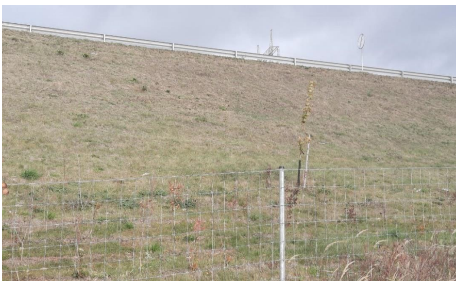
Obrázek 14: Násyp v km 41,300 současný stav (zdroj vlastní 2023)
