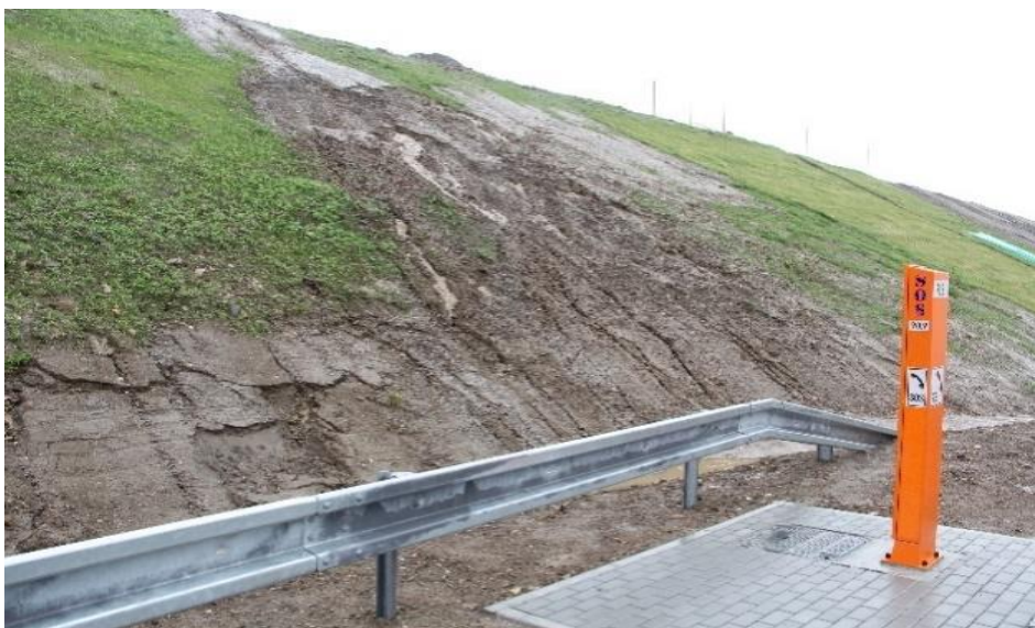
Obrázek 30: Sesuv vrchní vrstvy svahu před zapojením vegetace (zdroj Kozák 2013)
