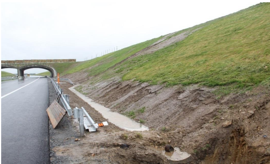
Obrázek 29: Zvodnělý svah zářezu D3 km 90,9 (zdroj Kozák 2013)
