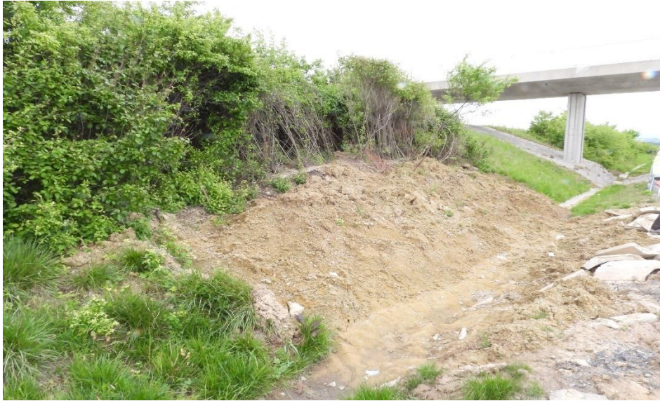
Obrázek 19: Sesunutý svah D1 km 304,0 (zdroj Kozák 2020)
