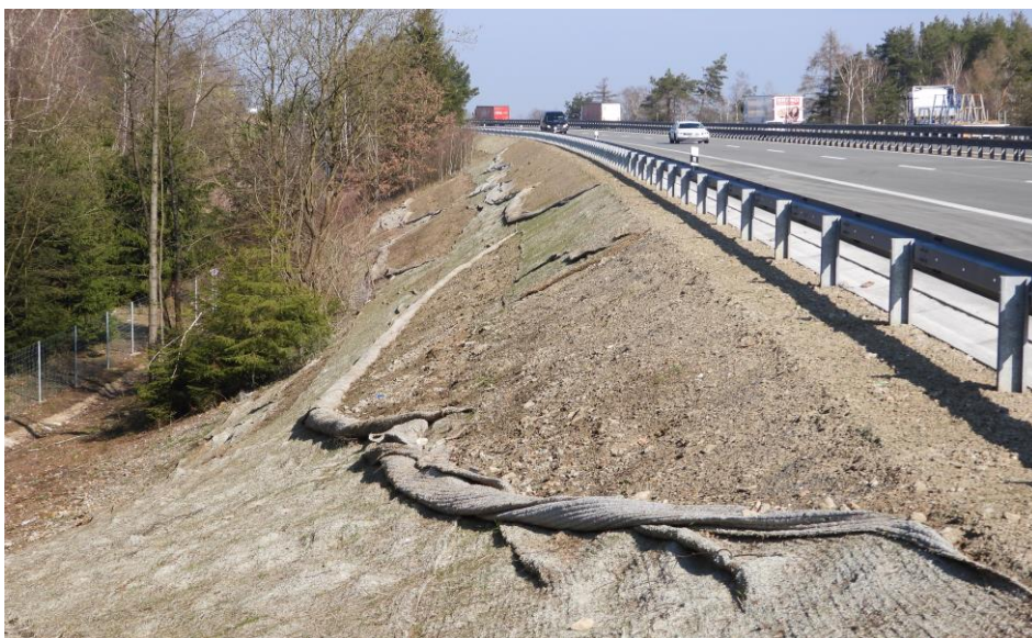
Obrázek 16: Nesprávné položení geotextilie D1 km 60,5 (zdroj Kozák 2020)
