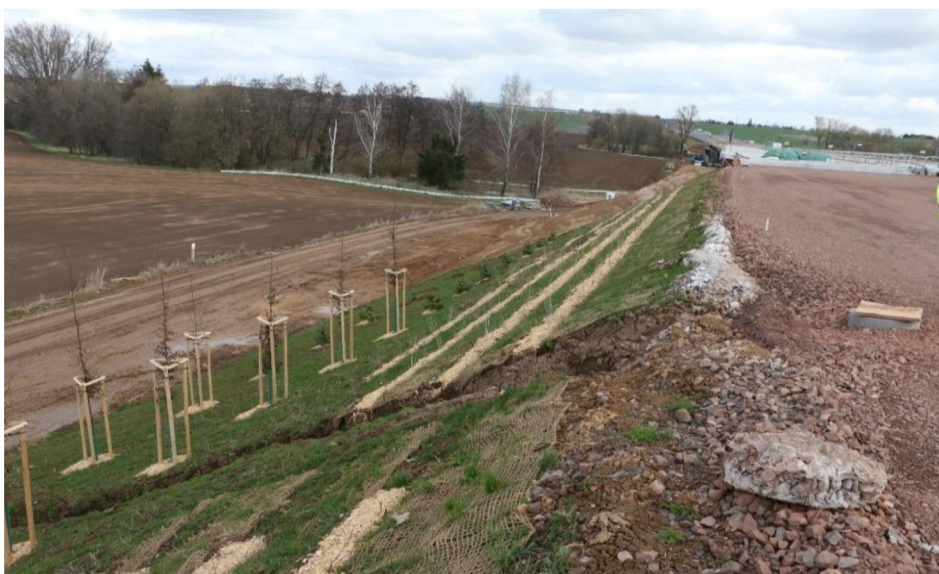
Obrázek 26: Erozní rýha na svahu D11 km 110,0 (zdroj Kozák 2021)
