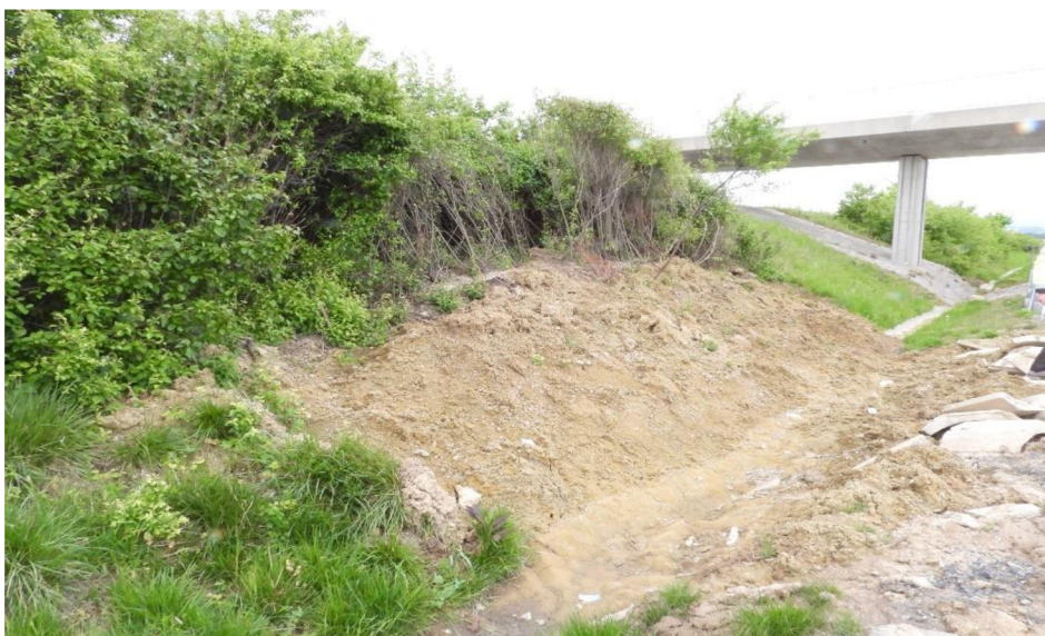
Obrázek 19: Sesunutý svah D1 km 304,0 (zdroj Kozák 2020)
