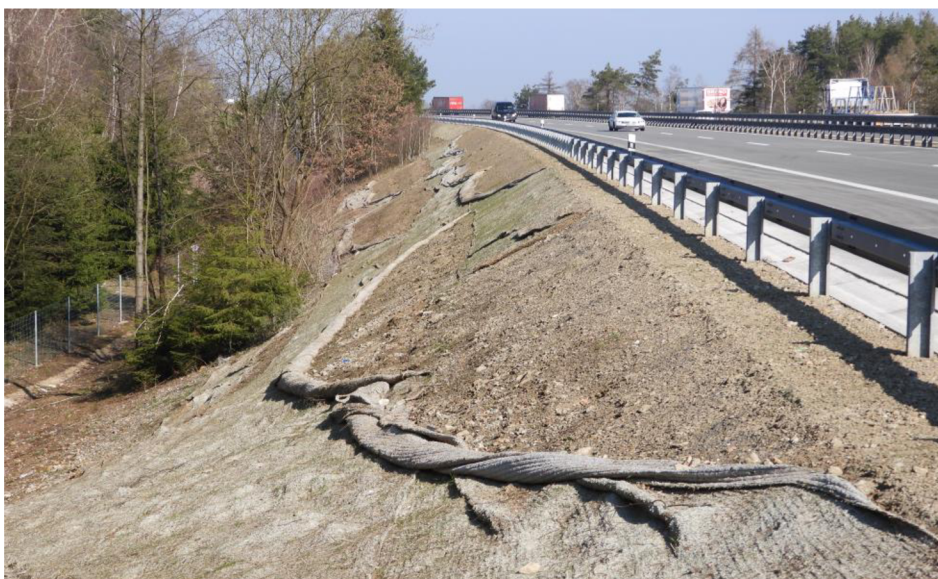
Obrázek 16: Nesprávné položení geotextilie D1 km 60,5 (zdroj Kozák 2020)
