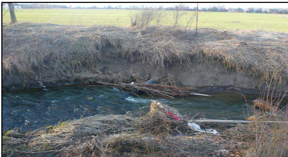
(Obr. 7.10. Obnažený plynovod v ř. km 1,525 - Petr Bujdák, 03/2011).
