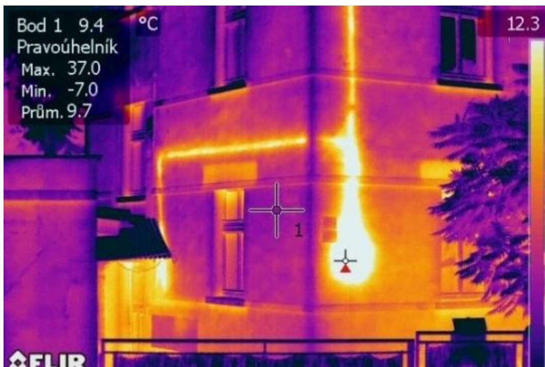
3) Příloha č. 3 - snímek pořízený termovizí
