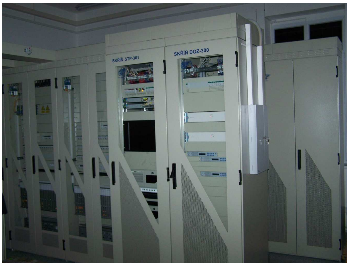
Obrázek 12: Elektronické stavědlo Zdroj: [17]
