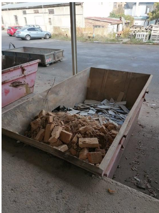
Obrázek 14: stavební odpad (vlastní, 2020).
