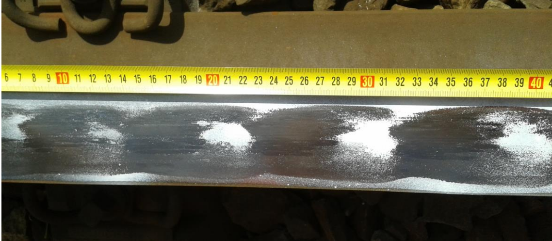
Obr. 79 Vlnvité deformace na úseku Hády
