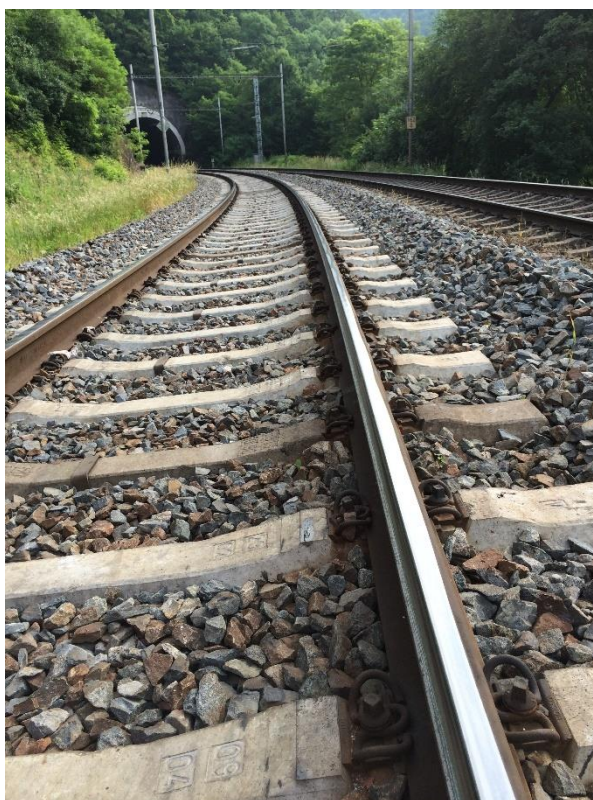
Obr. 18 Boční ojetí vnější kolejnice a vyměněné pražce
