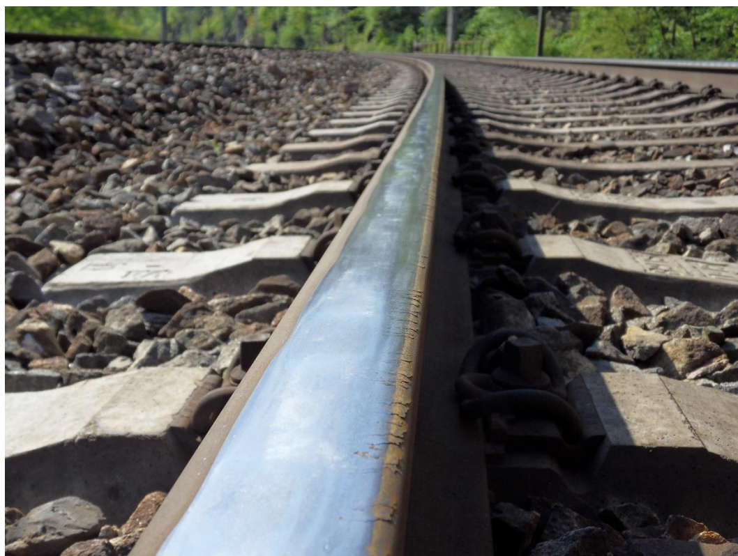
Obr. 13 Vady vnitřní kolejnice
