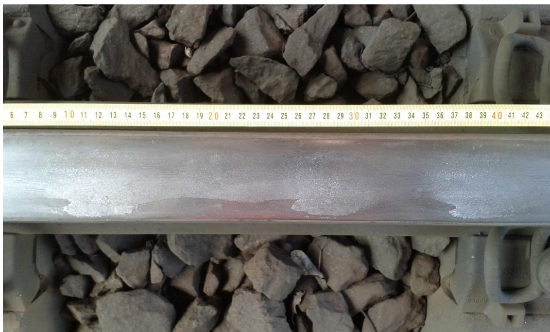
Obr. 28 Detail poježděné plochy hlavy kolejnice
