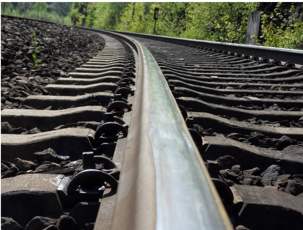
Obr. 9 Vady vnitřní kolejnice
