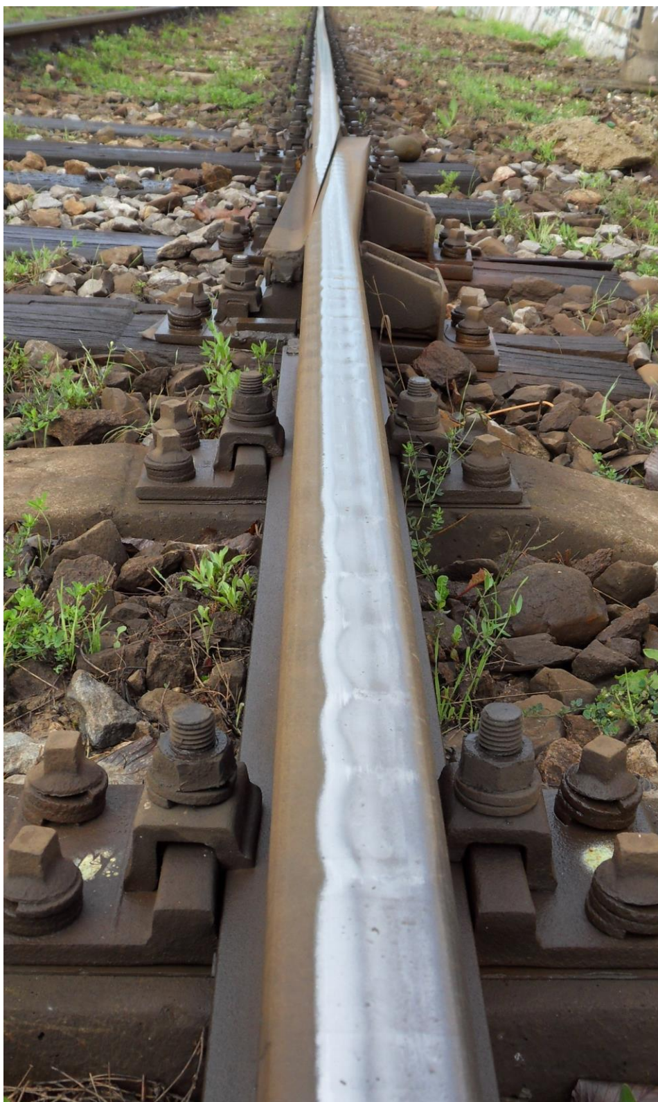
Obr. 2 Vlnky na tramvajové trati
