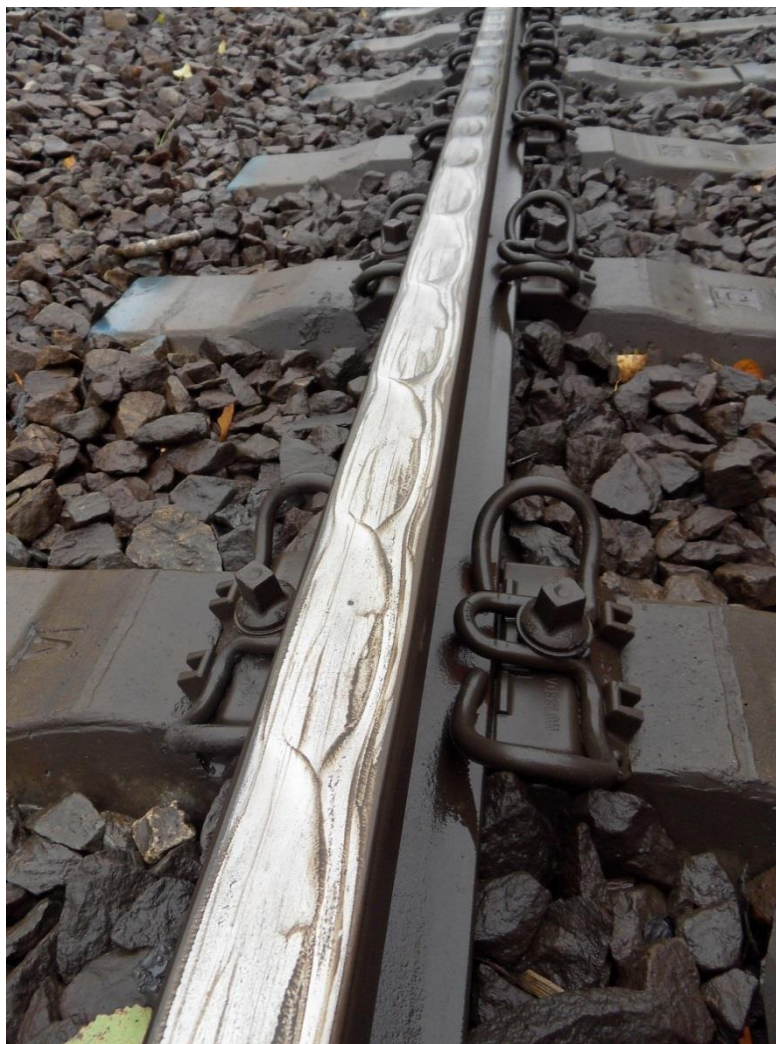
Obr. 51 Zvýrazněné skluzové vlny nečistotami v Havlíčkově Brodě
