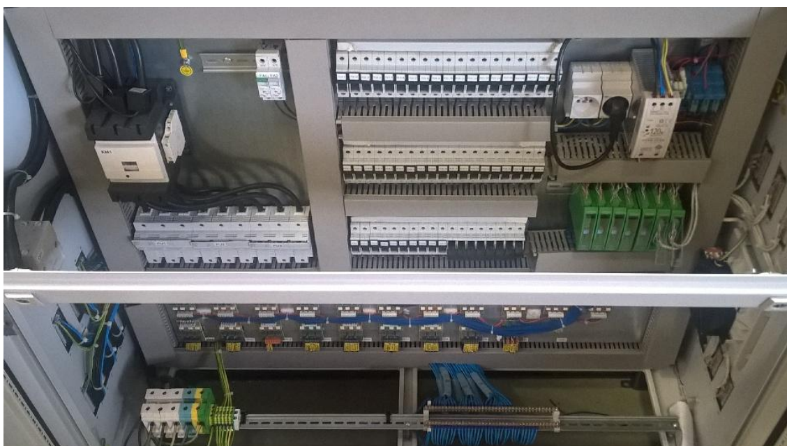
Příloha 6 - Realizace rozvaděče vnitřní pohled
