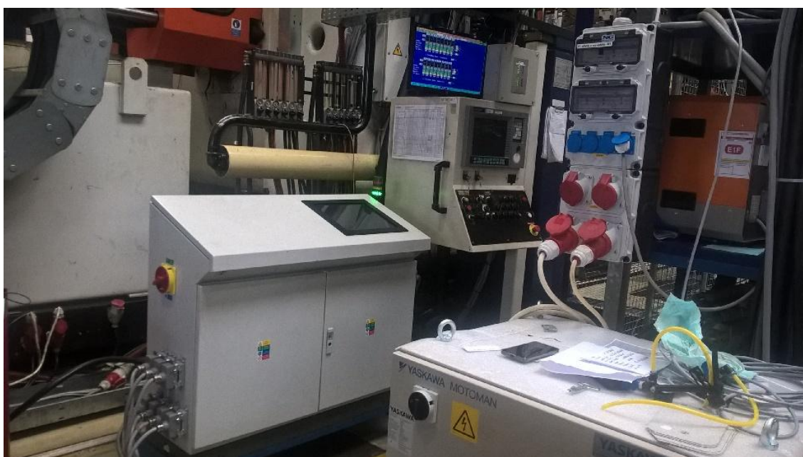
Příloha 7 - Instalace rozvaděče na vstřikovacím stroji HUSKY 2700
