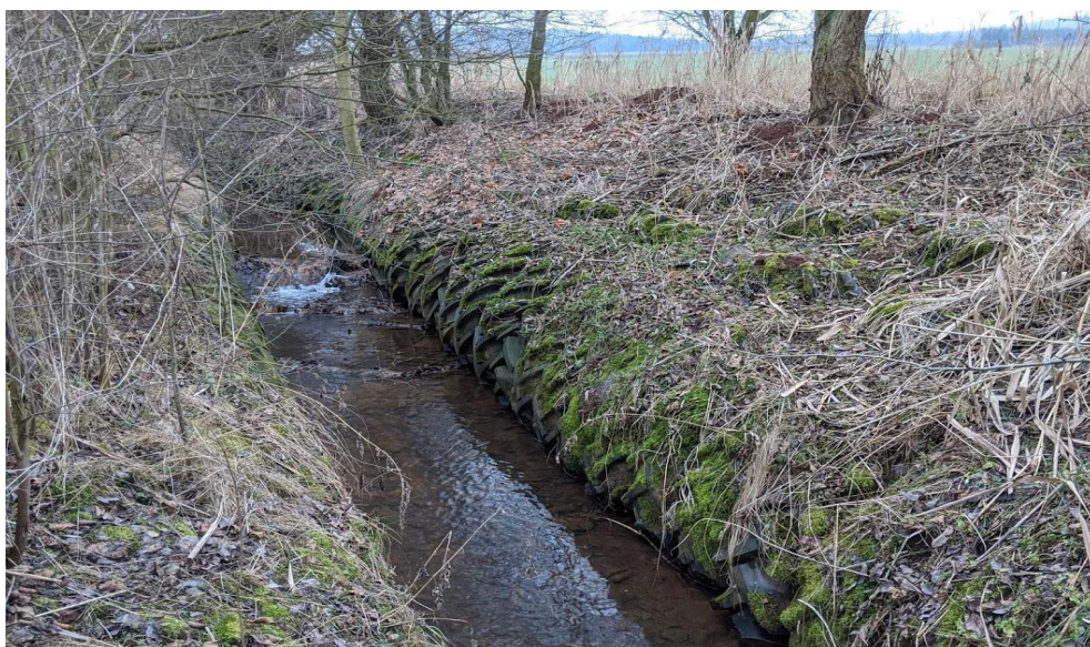
Obrázek č.22: Současný stav nevhodným způsobem regulovaného koryta „Gumový potok“. (autor: Jan Lukáš, 2020)
