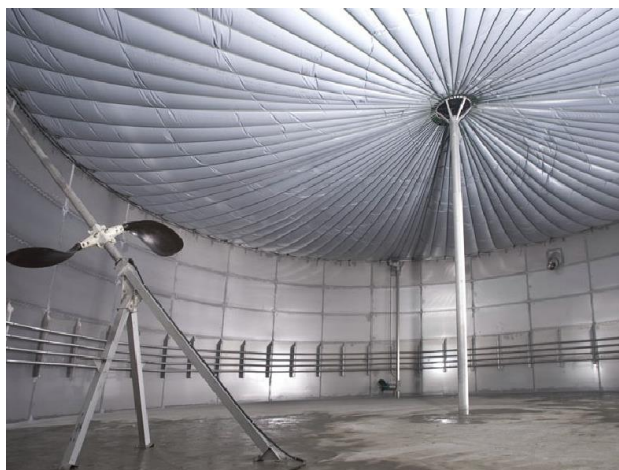
Obr. č. 2: Míchadlo uvnitř fermentoru
