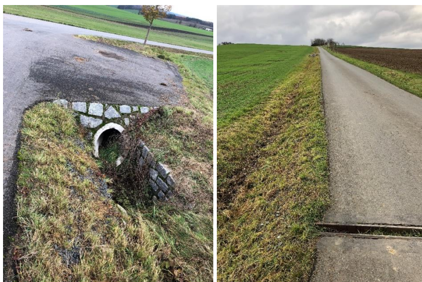
Obr. 44: Propustek a hospodářský sjezd na VPC 3.4 odvodnění a kryt vozovky; Obr. 45: VPC 3.4
