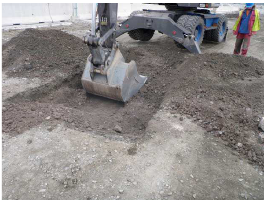
Obr. 6.5: Dálnice D4708 – odtěžování konstrukčních vrstev a svrchní části aktivní zóny, které byly postiženy objemovými změnami [24]
