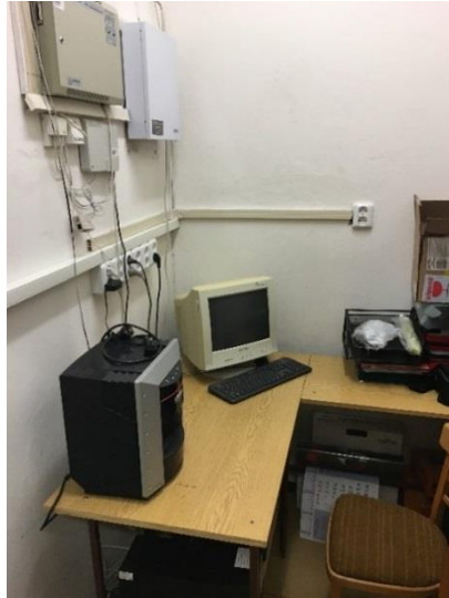
Obrázek č. 9: Serverovna (Zdroj: vlastní zpracování)
