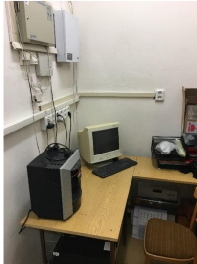
Obrázek č. 9: Serverovna (Zdroj: vlastní zpracování)
