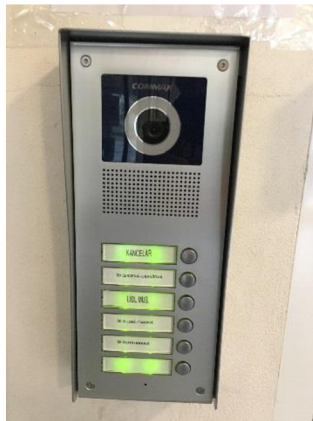
Obrázek č. 12: Zvonek s kamerou umístěný u hlavního vchodu do školy (Zdroj: vlastní zpracování)
