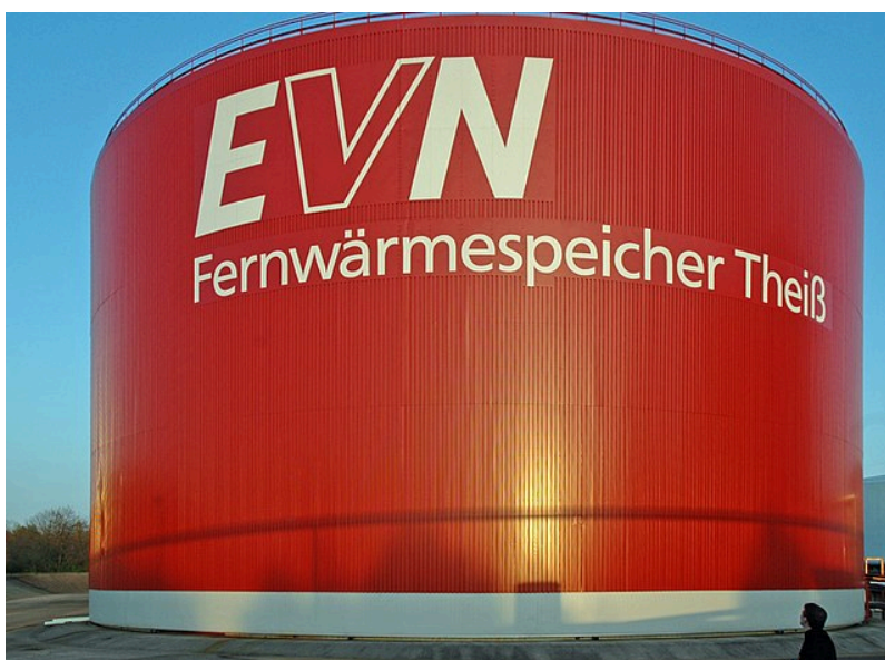
Obrázek 5 Akumulační věž pro dálkové vytápění v Dolním Rakousku s tepelnou kapacitou 2 GWh
