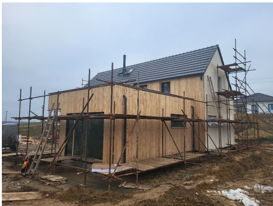
Obrázek 63 - RD Mělnická Vrutice ve fázi rozestavěnosti při provádění Blower – door testu (Brich, 2024).
