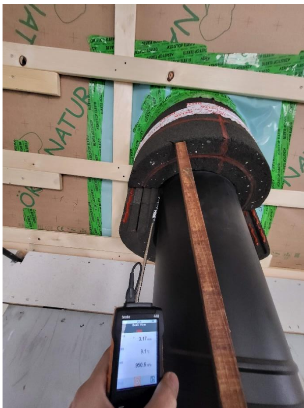
Obrázek 74 - Únik vzduchu v místě styku komínového tělesa s průchodkou z pěnoskla (Brich, 2024).
