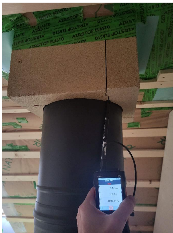
Obrázek 82 - Únik vzduchu v místě styku komínového tělesa se systémovou průchodkou (Brich, 2024).
