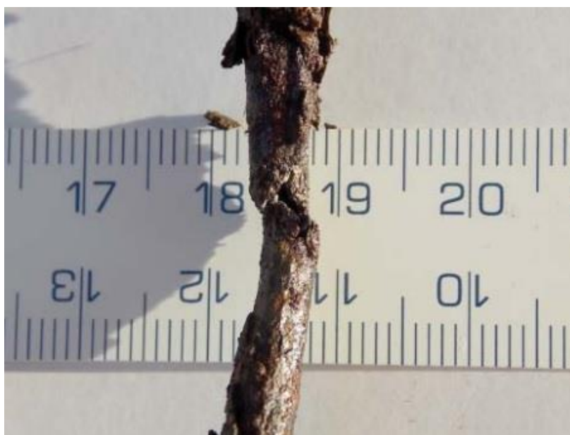
Obr. 19 Korozní poškození potrubí - detail Zdroj: Řehák, 2015
