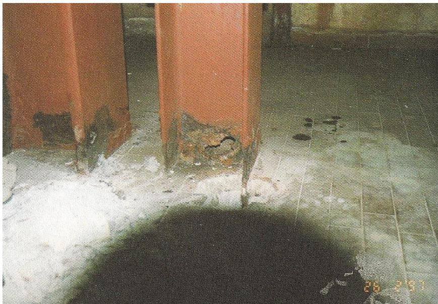
Obr. 15 Prokorodované nosné sloupy Zdroj: Vašek, 2011
