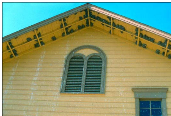
P4-8: Ptačí hnízda na krovu budovy
