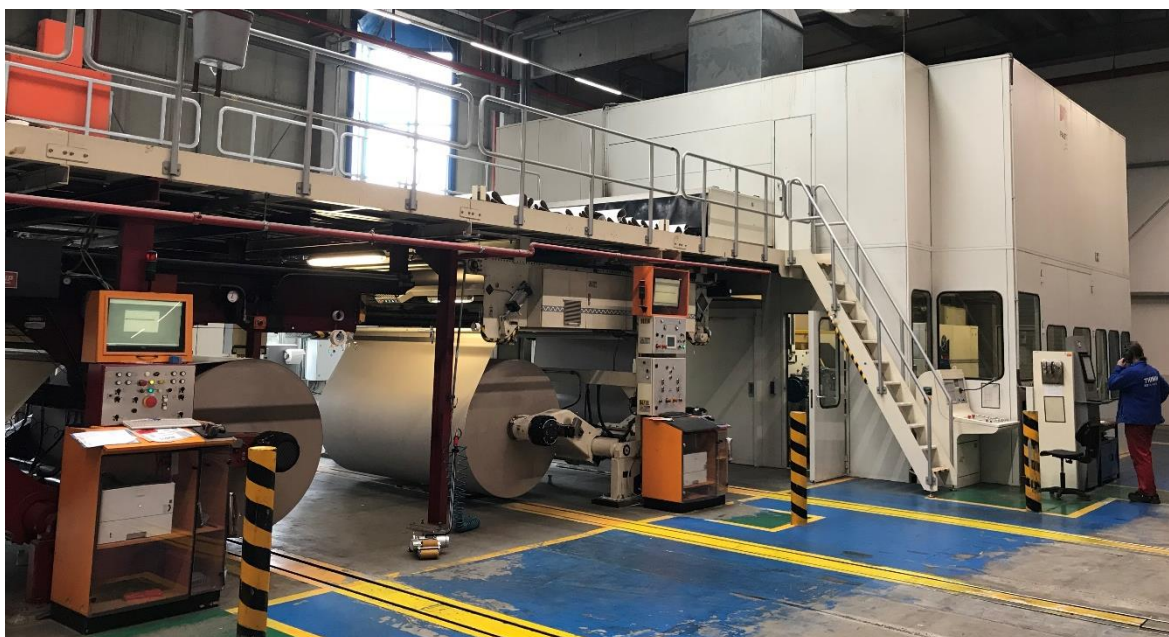
Obrázek 10 Odvíjecí stojan, převáděcí most a kabina se zvlňovací stolicí
