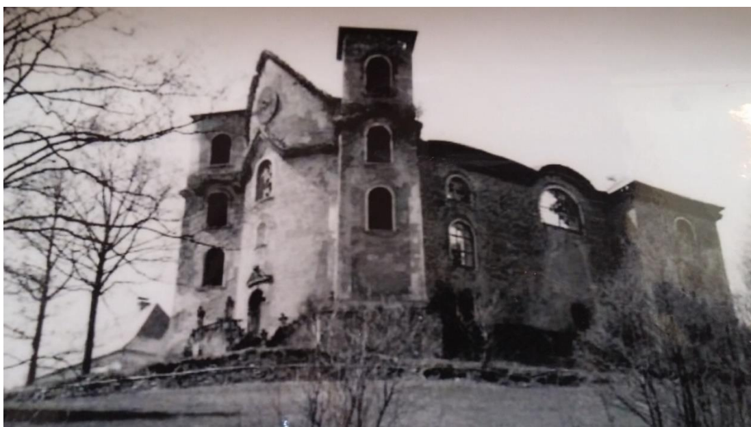
Obr. 35: Neratov, stav kostela kolem roku 1980 (foto – archiv FÚ Neratov)
