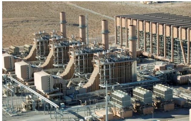
Obr. 1.5 Využití kotle na odpadní teplo [3]
