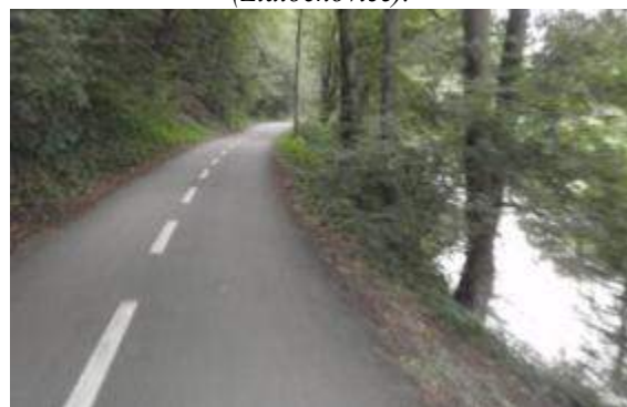
C-Obr. 40: Nedostatečně zajištěný svah ve směrovém oblouku (Svitava).
