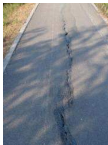
C-Obr. 45: Porucha krytu nemotorové komunikace způsobená nevhodným řešením náspu a krajnice.
