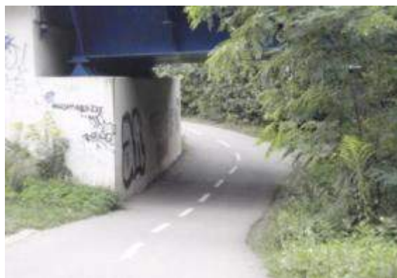
C-Obr. 42: Zúžení stezky ve směrovém oblouku, nebezpečné řešení podjezdu (Svitava).
