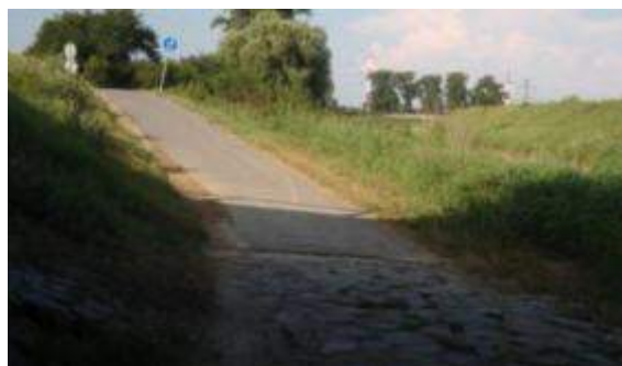
C-Obr. 38: Nevhodné řešení úpravy povrchu komunikace pro nemotoristy pod mostem (Židlochovice).
