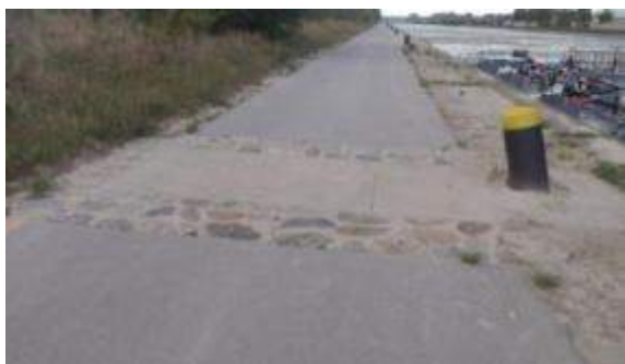
C-Obr. 37: Nevhodně řešené úpravy krytu přes vedení sítí pod komunikací pro bruslení (Vídeň).
