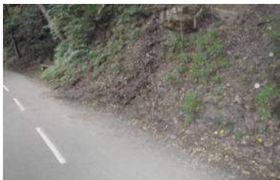
C-Obr. 39: Nevhodně zajištěné svahy, nedostatečná nezpevněná krajnice, neudržovaný úsek (Svitava).
