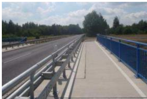
Obr. 62: Záchytné zařízení v podobě svodidel a zábradlí na mostě (Lužická jezera).
