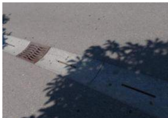
Obr. 52: Nevhodný odvodňovací prvek, který slouží jako oddělení chodců a cyklistů.
